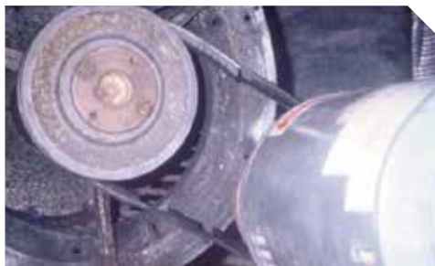
Рис. 2 Ремни вентиляторов следует регулярно осматривать и заменять по необходимости: ремень на фото непригоден для использования
