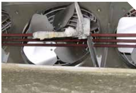
Рис. 1 Засорение сопел спрея в шкафу 6
