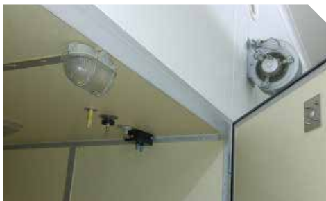
Рис. 1 Отверстие, просверленное в двери и защищенное металлической пластиной, позволяет поместить калибровочный зонд рядом с зондом шкафа
