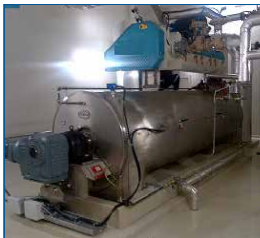
Figura 1: Condizionatore a vapore utilizzato da Aviagen per il trattamento termico delle materie prime.
