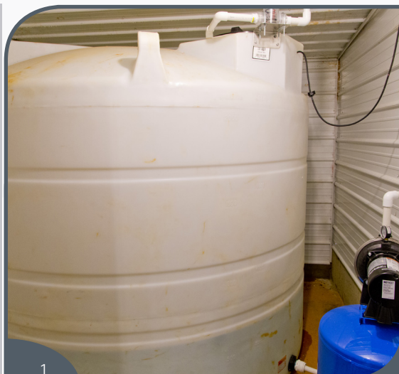
1 Vascone di stoccaggio per acqua sanificata
